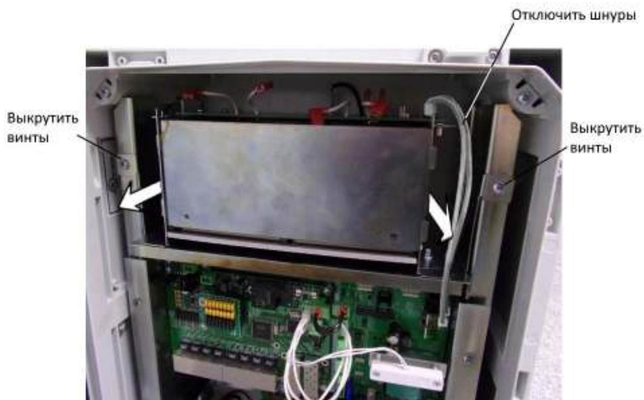
Рис. 7.1.1. Извлечение отсека АКБ
