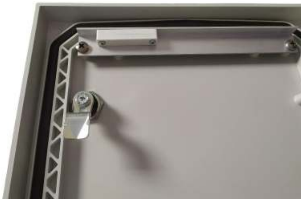
Рисунок 3.6.1 - Датчик вскрытия на крышке коммутатора
