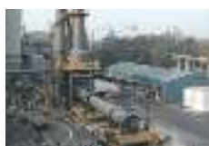
Завод по утилизации отходов
