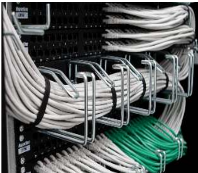
Пример установки горизонтальных организаторов.
