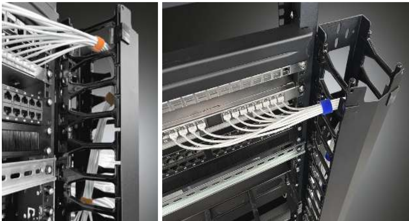
Пример установки вертикального кабельного организатора в открытой стойке
