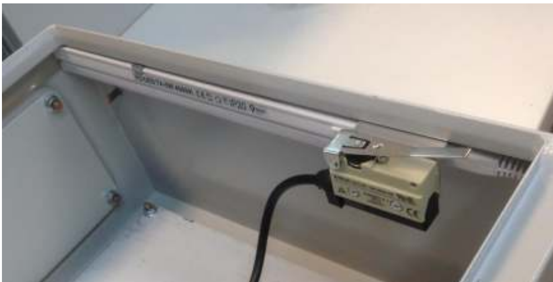
Рис.3.2.9-2 Установленные выключатель вскрытия и светильник.
