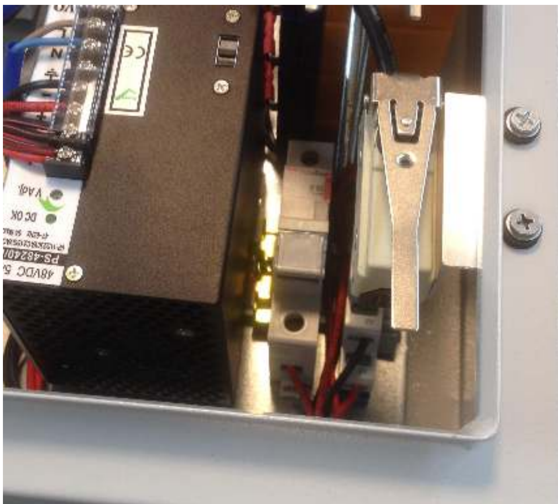
Рис.3.2.9.-1 Установленный выключатель вскрытия.
