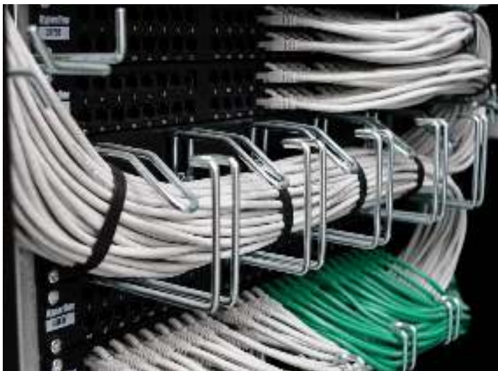
Пример установки горизонтальных организаторов.
