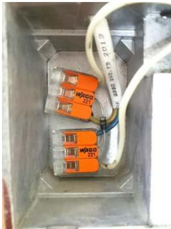
Рисунок 5 - Внешний вид подключения в монтажном отсеке замка
