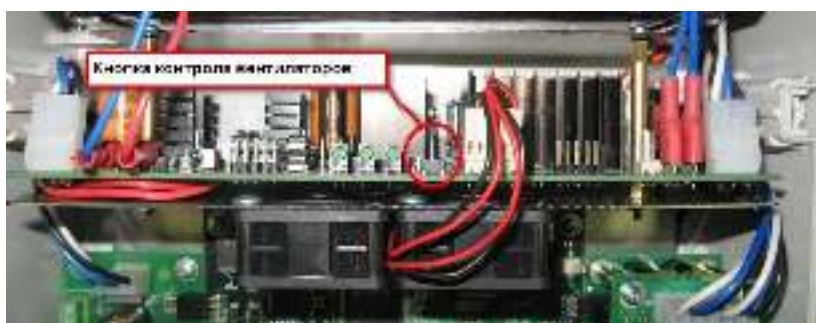
Рис. 2.9.6. Проверка работоспособности вентиляторов.
